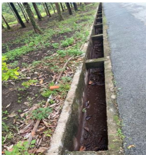
Mương thoát nước mưa
