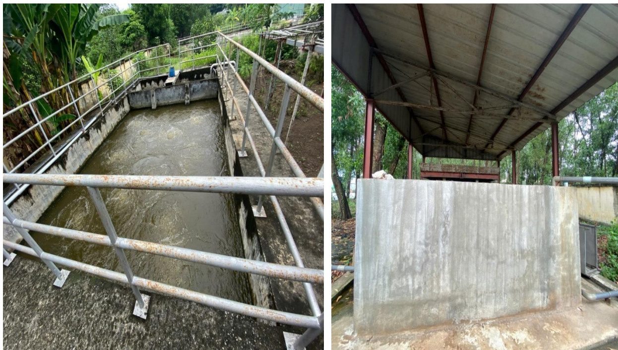
Hình 10. Hệ thống xử lý nước thải của Cơ sở
