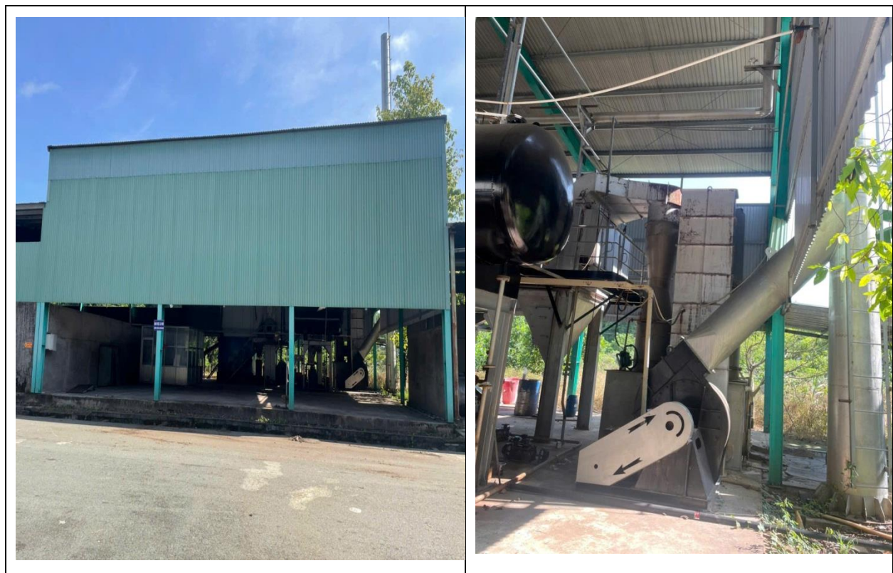
Hình 12. Hệ thống xử lý khí thải lò hơi
